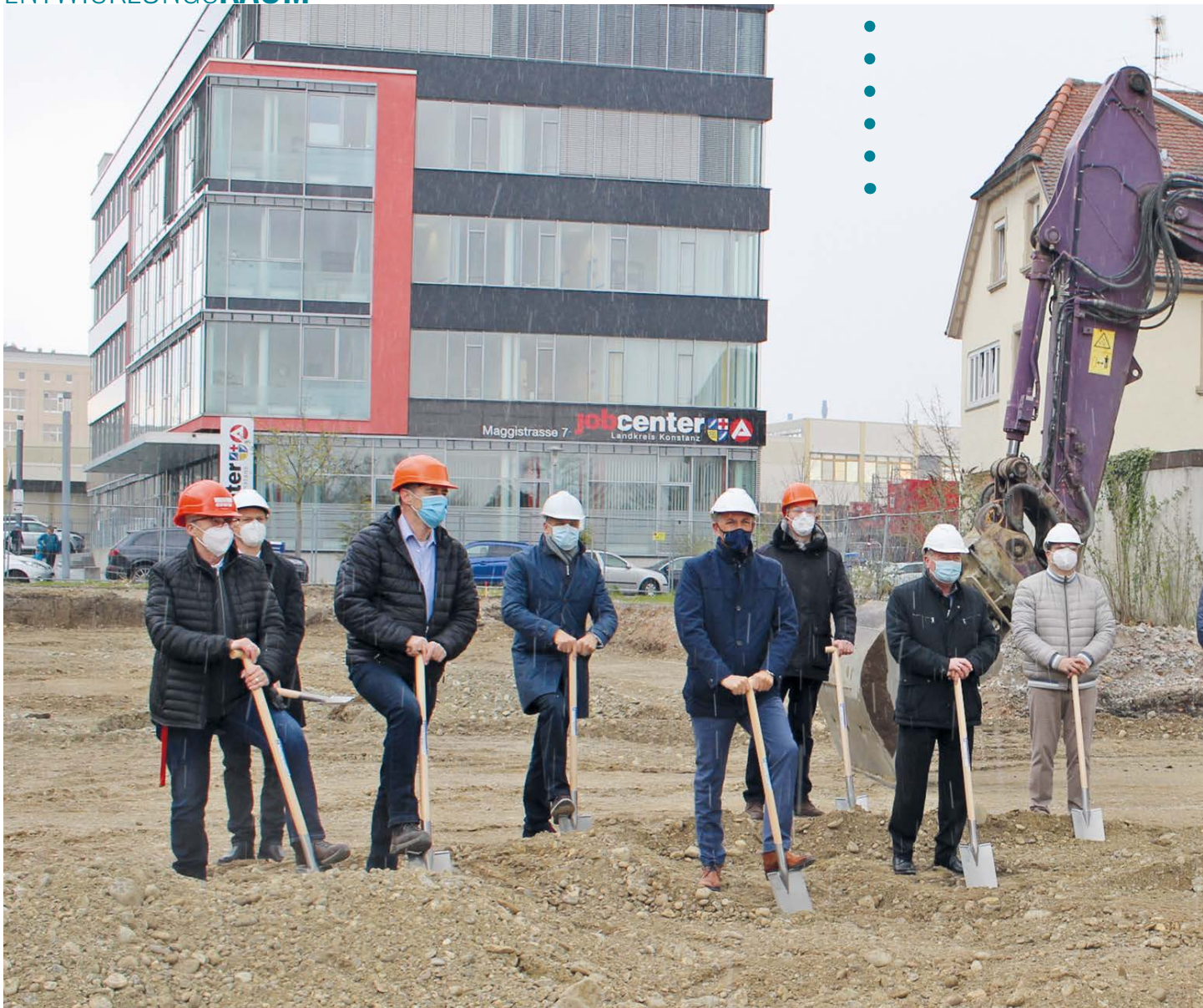
Gemeinsamer Spatenstich im April diesen Jahres für ein großes, genossenschaftliches Projekt im Herzen von Singen.
