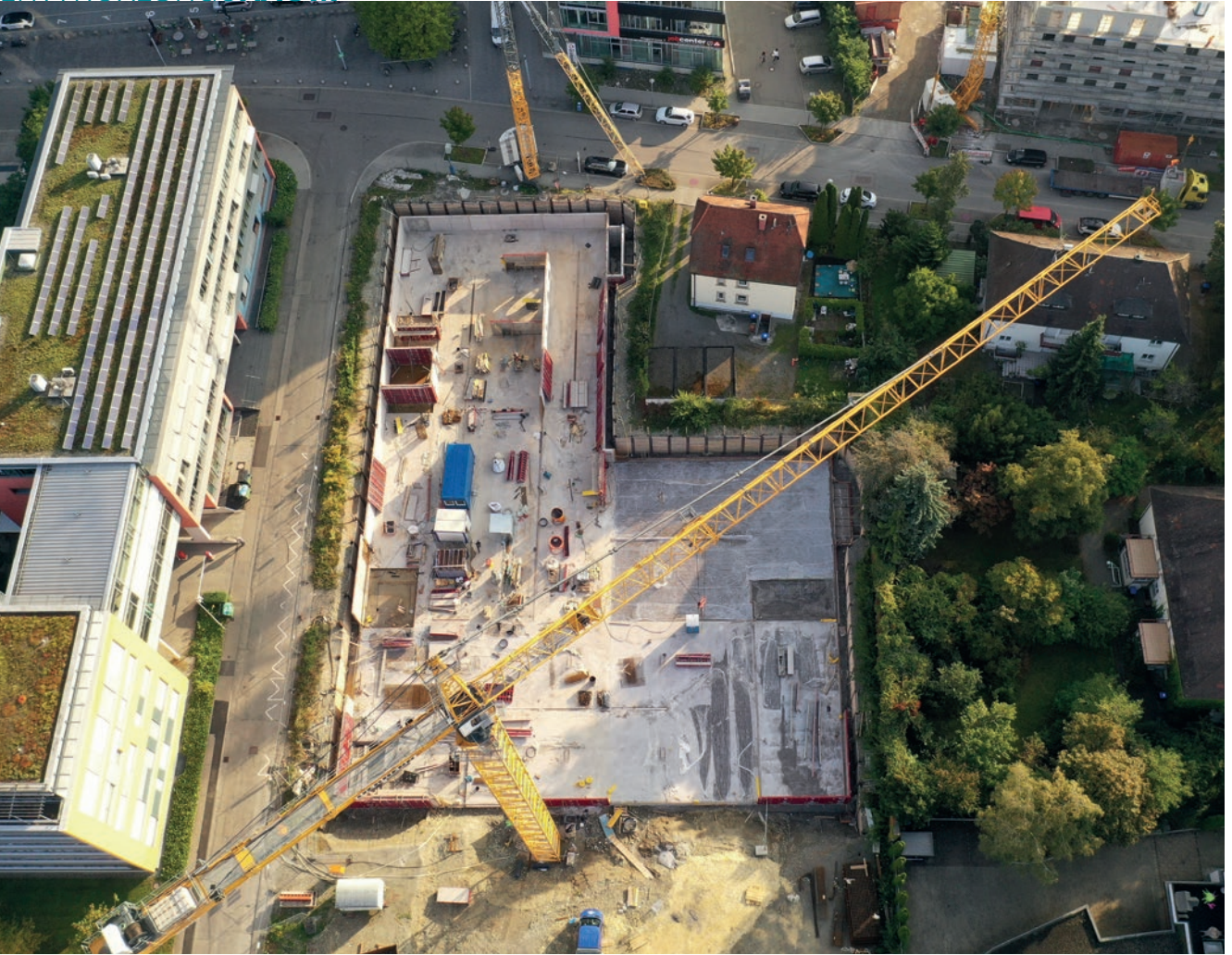
Das Bauvorhaben Wehrdstraße, nahe des Hegautowers, ist Teil des städtebaulichen Rahmenplans „Zukunft Singen Süd“. Foto: ©Luftaufnahme GEMA, Hr. Engel.
